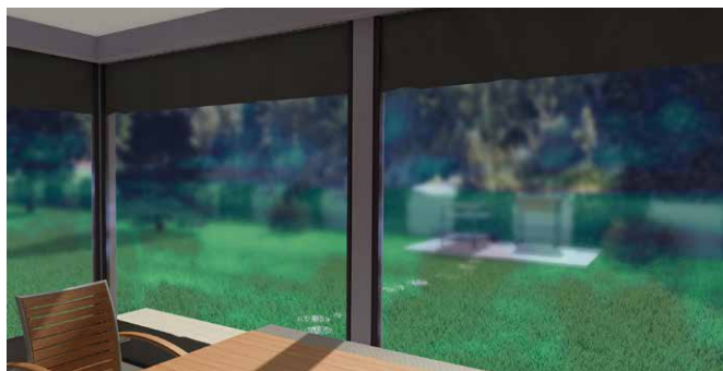
Eintrübung/blauer Schimmer aufgrund von Feuchte – Sichtfenster läuft waagrecht durch bis zur Führungsschiene (im Bereich des Sichtfenster ist senkrecht kein Tuch mehr).
